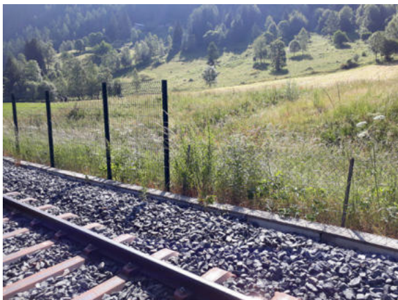
Affaissement de la clôture côté piste agricole
